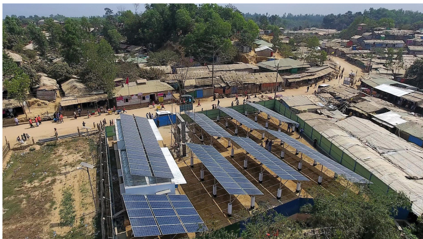
Figure 6.11 Installation combinée sur toiture et sur mâts dans le système de pompage de l'OIM, extension du camp de réfugiés de Kutupalong Balukhali (photo de couverture) Source : OIM Bangladesh
