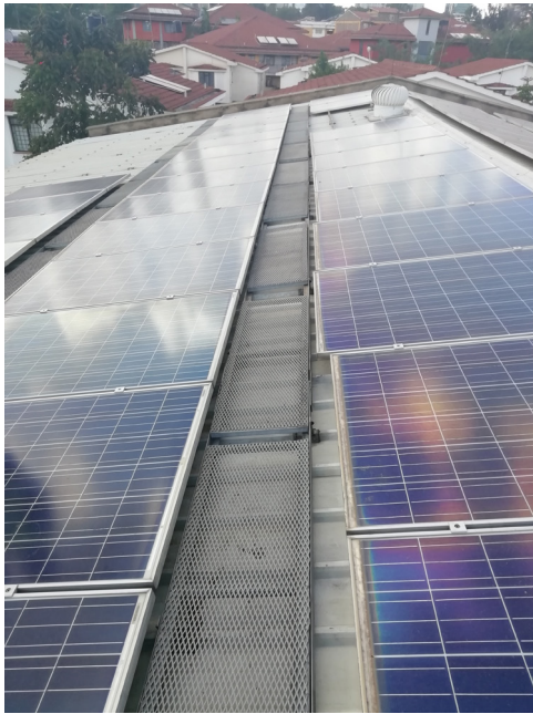
Figure 6.18 Couloir de maintenance entre des modules montés sur toiture à l'université de Strathmore, Kenya
