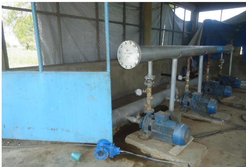
Figure 6.3 Pompes de surface horizontales installées sur une dalle en béton à la station de pompage d'Itang, Éthiopie
