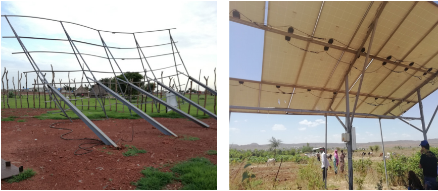
Figure 6.14 Effondrement d'une structure sur mâts, Yida, Soudan du Sud (à gauche), modules arrachés par le vent à Fafen, Éthiopie (à droite)
