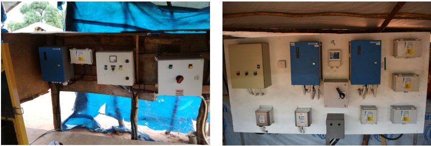
Figure 6.7 Exemples de bonne gestion du câblage au Soudan du Sud et en Tanzanie respectivement
