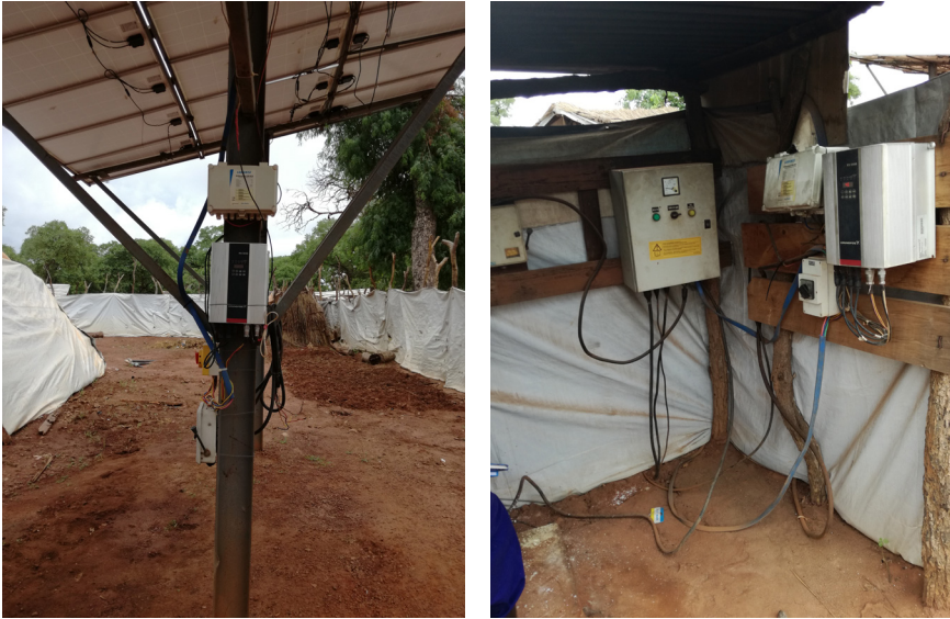
Figure 6.6 Exemples de mauvaise gestion du câblage au Soudan du Sud
