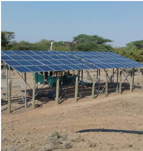
Figure 7.3 SPS grillagé avec un éclairage solaire de sécurité à Turkana, Kenya
