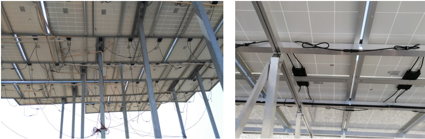
Figure 6.17 Exemple de câbles de modules mal et bien ordonnés
