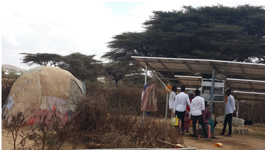
Figure 5.8 Boîtier d'onduleur placé sous les modules dans la région de Somali, Éthiopie
