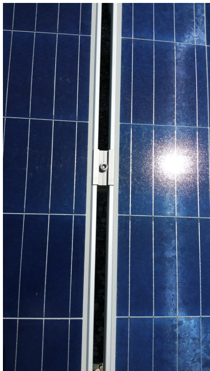
Figure 4.3 Écarteurs placés entre les modules pour améliorer le refroidissement
