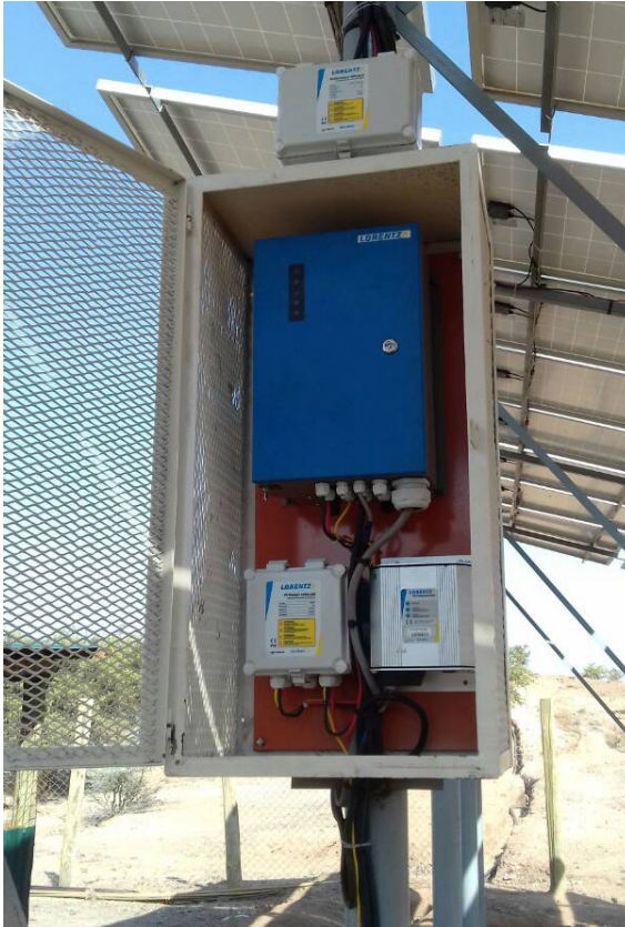
Figure 6.5 Onduleur installé dans une armoire grillagée verrouillable sous le groupe PV à Turkana, Kenya Source : Oxfam
