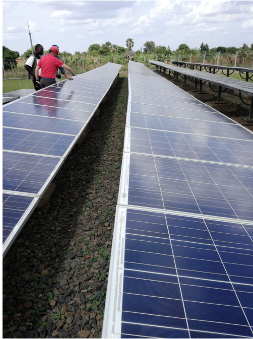
Figure 6.19 Couloir de maintenance dans une installation au sol à Koboko, Ouganda
