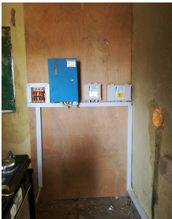
Figure 6.4 Dispositifs de commande installés (de gauche à droite) : commutateur CA, onduleur, parasurtenseur, interrupteur de déconnexion PV
