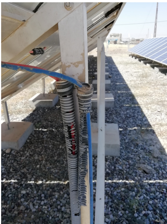
Figure 3.9 Conduits endommagés par les hautes températures en Irak
