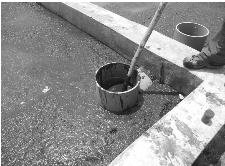
Foto 5.4 Tuberías de conexión bloqueadas
