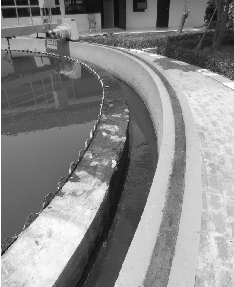
Foto 5.5 Flujo desequilibrado debido a la mala nivelación del vertedero
