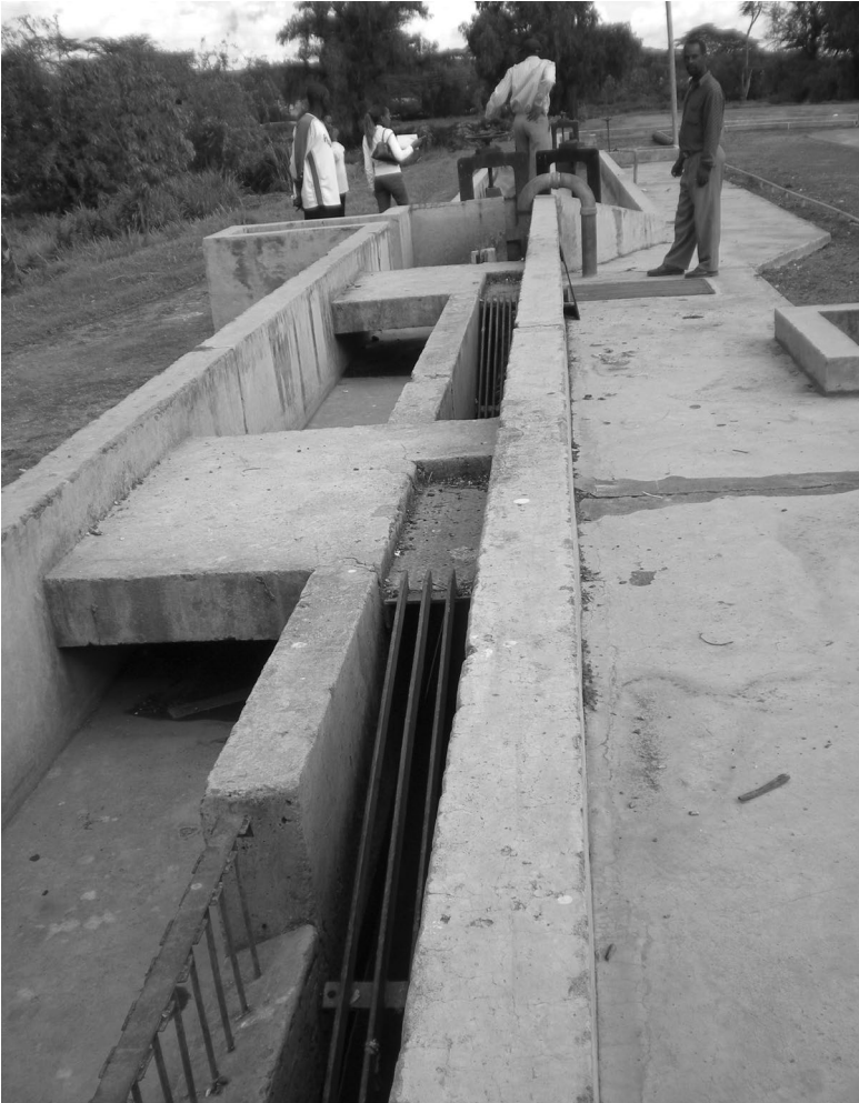
Foto 5.3 Rejas inclinadas con acceso para el operador
