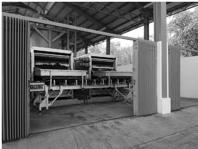
Foto 7.4 Filtro prensa de banda en la planta de tratamiento de lodos sépticos de Duri Suwung, Denpasar (Indonesia) Fuente: Chengyan Zhang de Stantec
