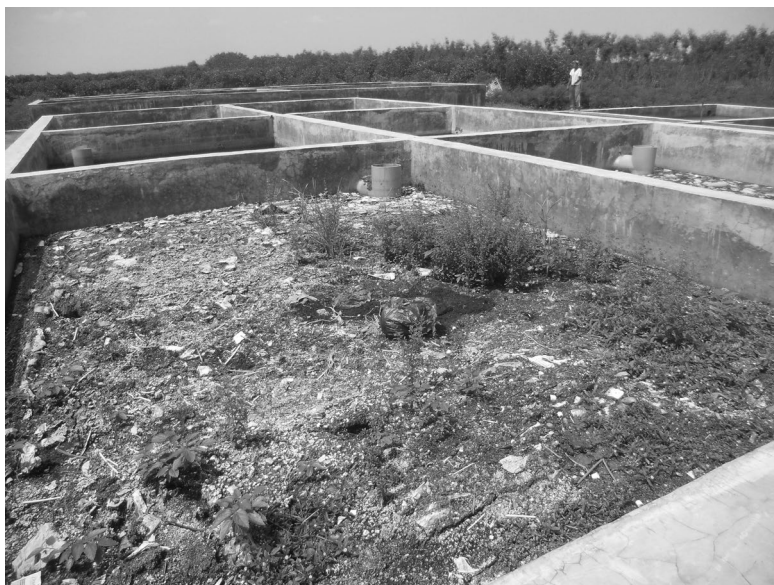
Foto 5.1 Problemas de gestión de lodos en una laguna anaeróbica, Tegal (Indonesia) (obsérvese la falta de disposiciones para el acceso del operador a los tanques)
