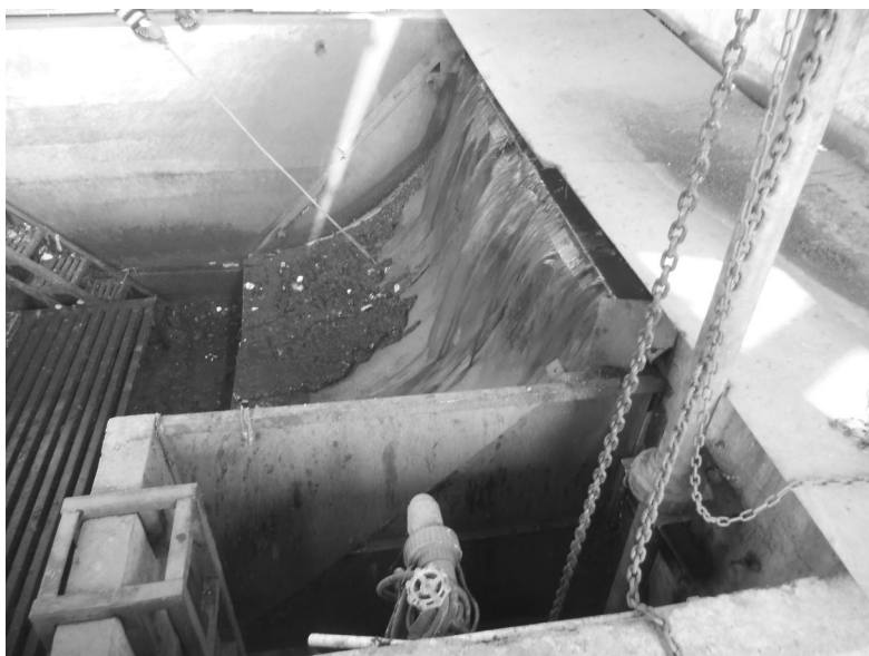
Foto 6.7 Reja horizontal en la planta de tratamiento de lodos sépticos en Pulo Gebang
