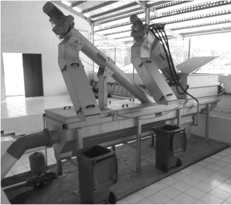
Foto 6.8 Unidad combinada de cribado y eliminación de arenas mecánica, Yakarta
