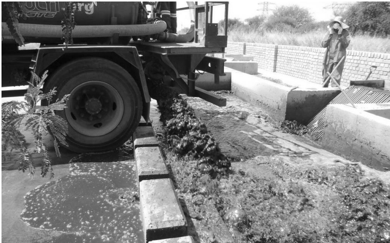
Foto 6.3 Unidad de recepción de plataforma que podría ser mejorada ajustando los niveles, de manera tal que la plataforma sea más baja que la superficie en donde está el camión cisterna, Gaborone (Botsuana)
