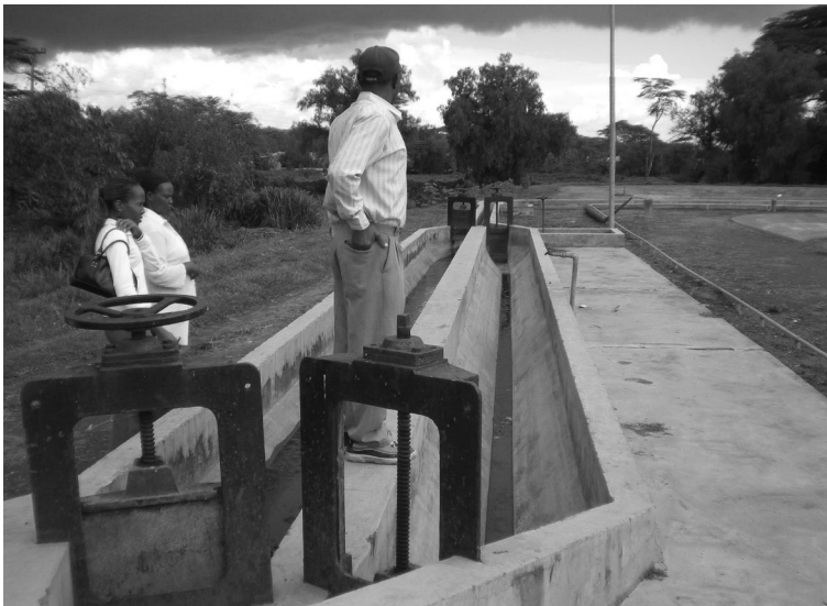
Foto 6.9 Canal desarenador en una planta de tratamiento de aguas residuales en Naivasha (Kenia)
