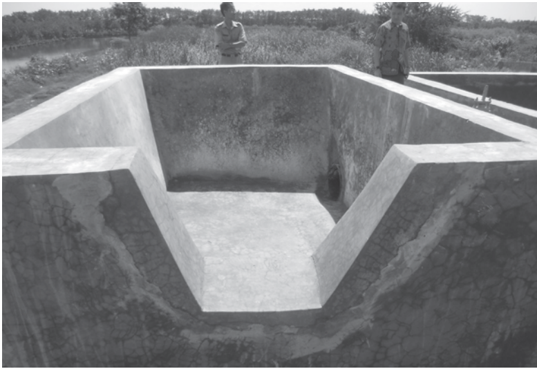
Photo 6.2 Fosse de dépotage, Tegal, Indonésie
