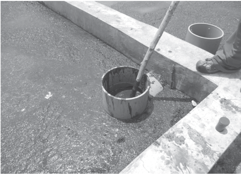
Photo 5.4 Colmatage de conduites de raccordement entre deux bassins
