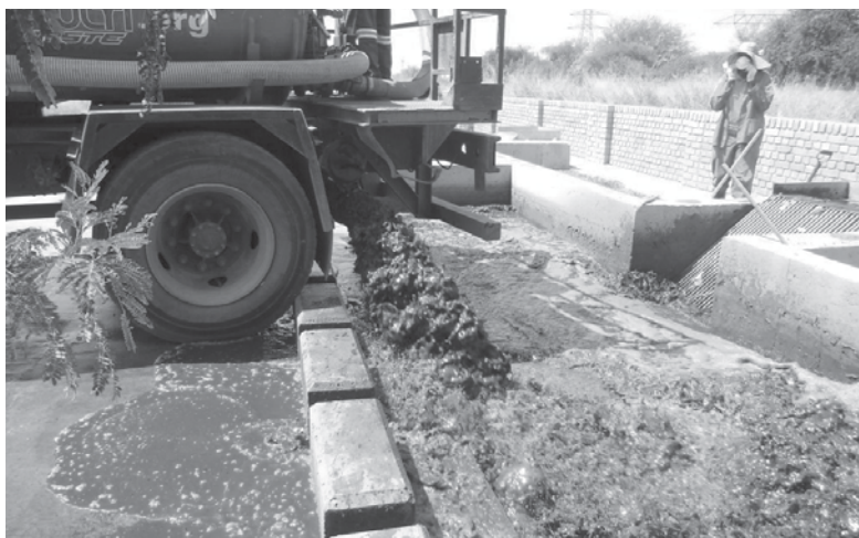
Photo 6.3 Radier pour le dépotage, qui pourrait être amélioré en faisant en sorte que le niveau du radier soit en dessous du niveau de l'aire de stationnement du camion
