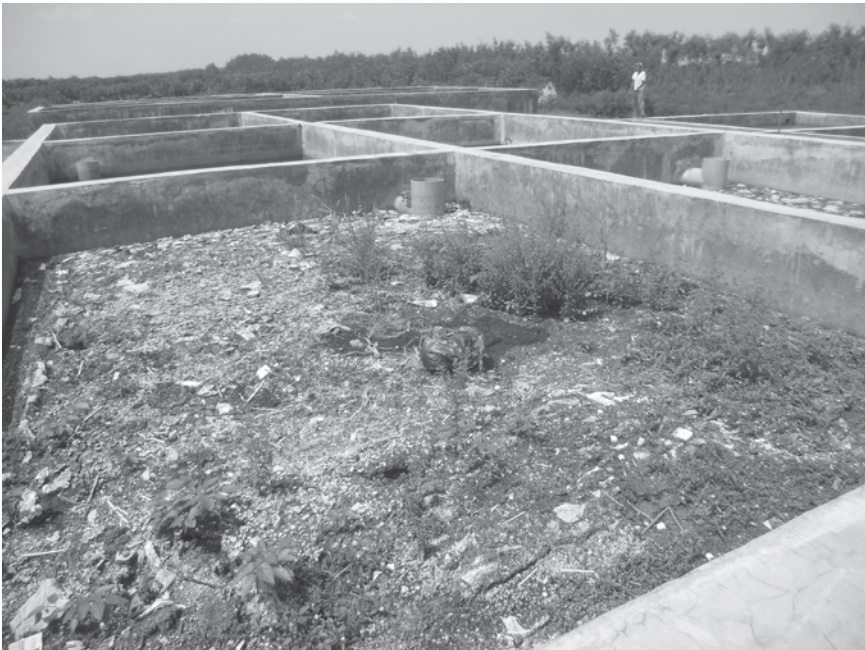
Photo 5.1 Problèmes de gestion des boues dans un bassin anaérobie à Tegal en Indonésie (à noter l'absence de dispositions pour faciliter l'accès des opérateurs aux bassins)
