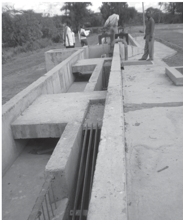
Photo 5.3 Dégrilleur incliné et accessible pour l'opérateur
