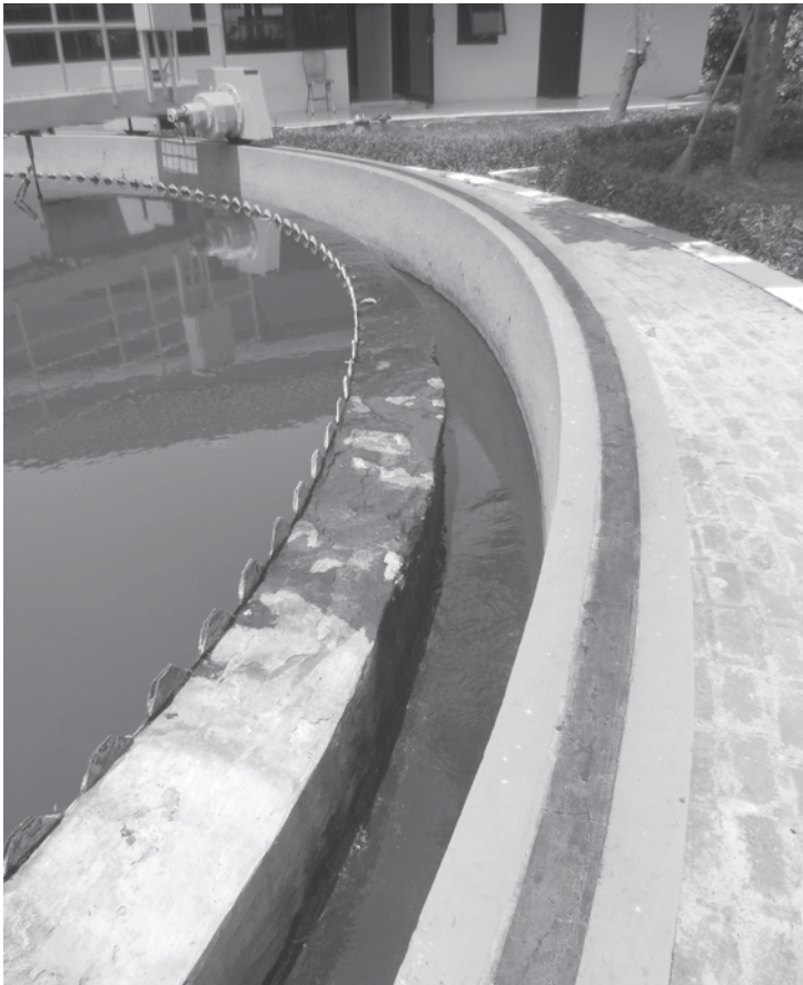
Photo 5.5 Écoulement non-équilibré causé par un défaut de nivellement du déversoir
