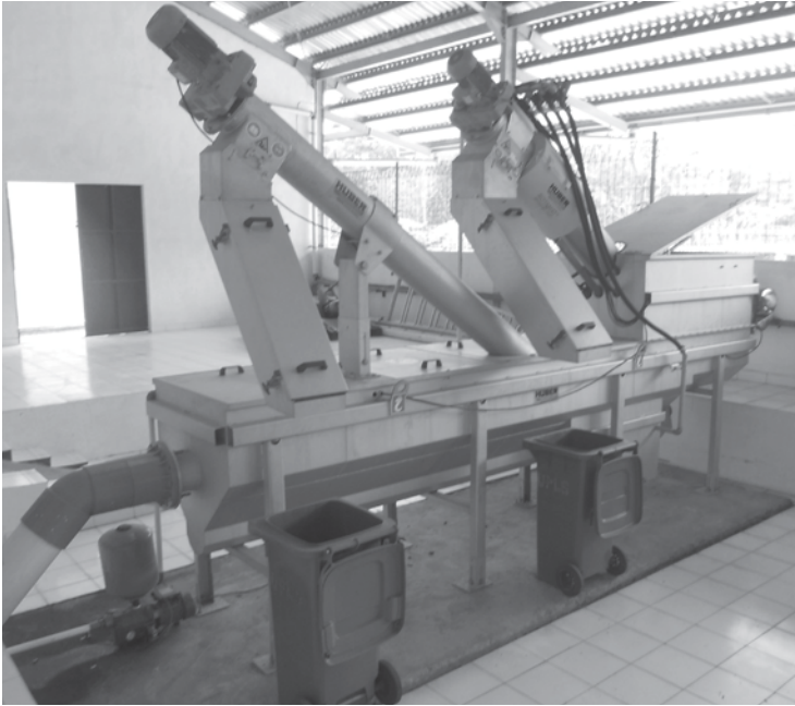
Photo 6.8 Unité combinée de dégrillage et de dessablage à Jakarta
