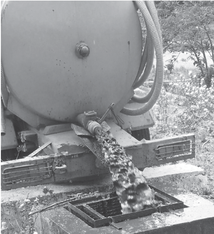
Photo 6.1 Le dépotage directement dans une fosse Imhoff n'est pas une configuration satisfaisante en raison des projections et des débordements
