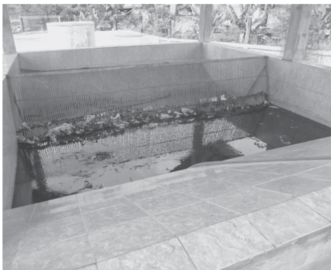
Photo 5.2 Dégrilleur vertical sans accès prévu pour l'opérateur
