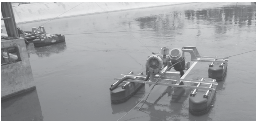
Photo 8.2 Aérateur de surface à grande vitesse à Duri Kosambi à Jakarta
