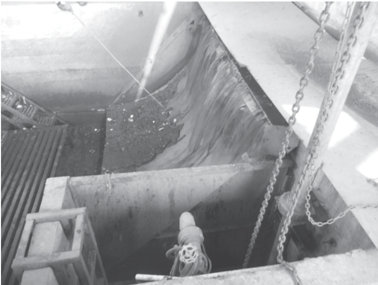
Photo 6.7 Dégrilleur fin horizontal de la station de traitement des boues de Pula Gebang
