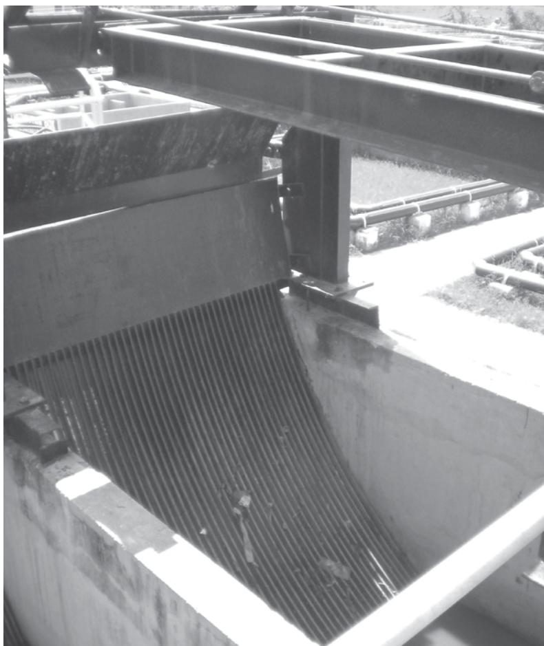
Photo 6.6 Dégrilleur incurvé muni d'un mécanisme de raclage rotatif
